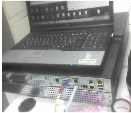
Figure 13 : Routeur de la salle commutation
